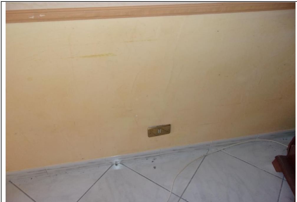
Foto n. 24 Impianto elettrico stato d'uso
