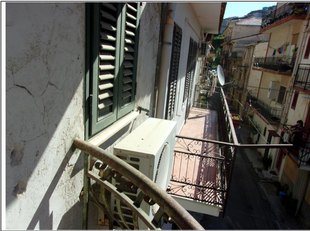
Foto n. 30 impianto esterno climatizzatore
