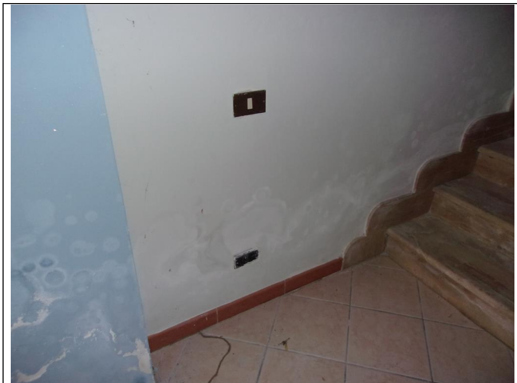
Foto n. 16 infiltrazioni da perdita cisterna ed impianto elettrico
