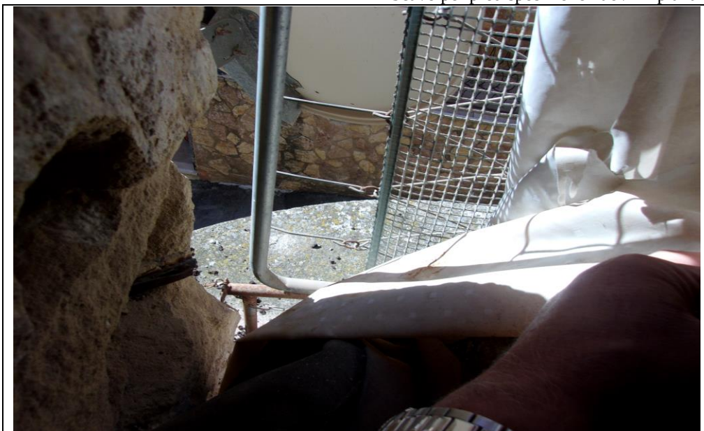
Foto n. 58 piano superiore deposito Balcone non accessibile ed al rustico
