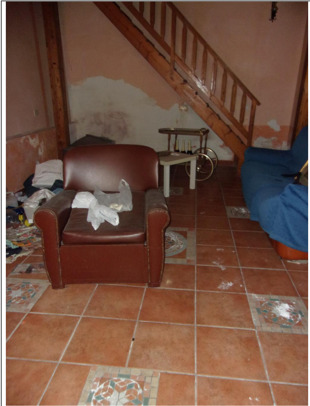
Foto n. 40 pavimentazione piano terra e Tracce umidità provenienti dalla cisterna interna adiacente
