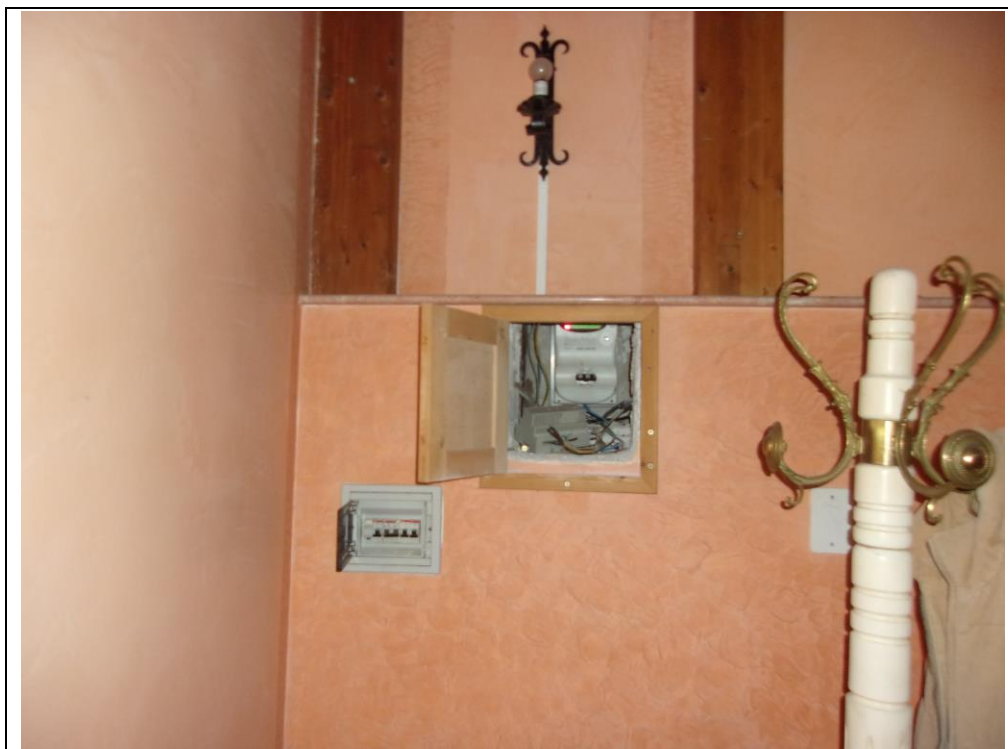
Foto n. 36 linea accesso impianto elettrico
