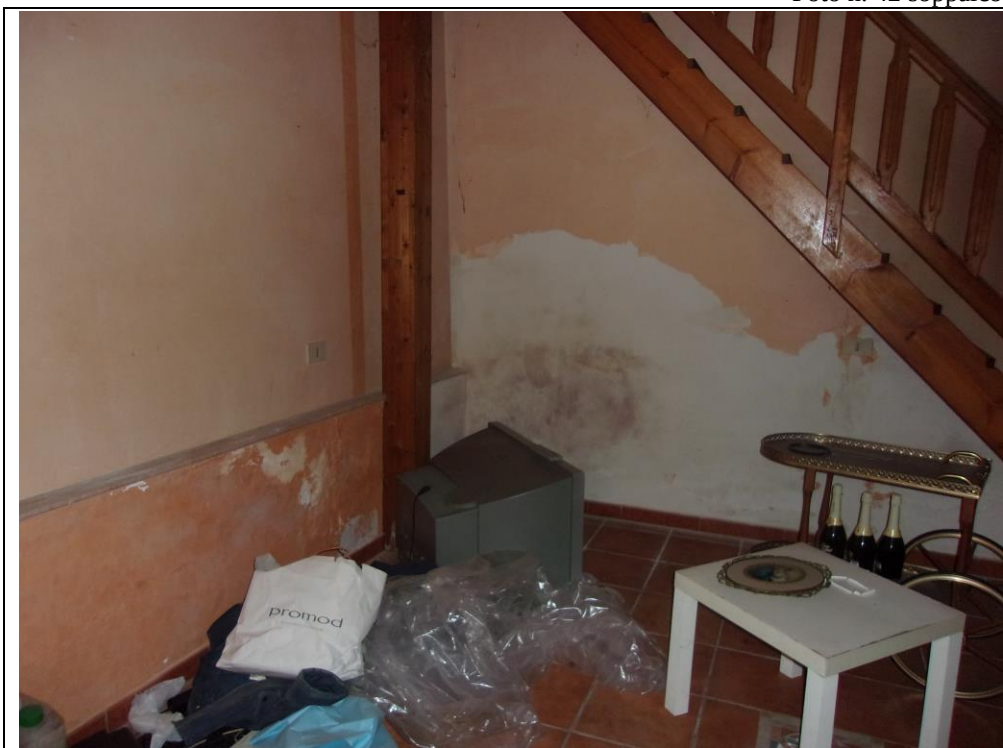
Foto n. 43 tracce di umidità piano terra
