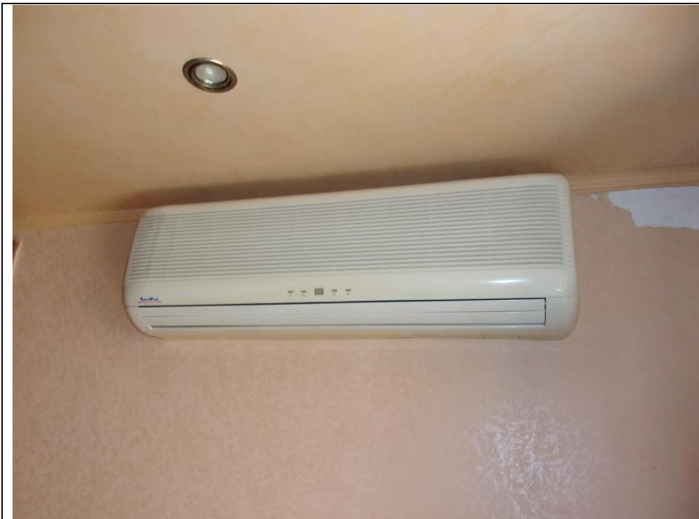
Foto n. 31 impianto interno climatizzatore
